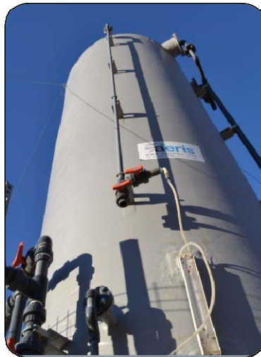
Bioreactor AERIS-SOX per la dessulfuració de biogàs
