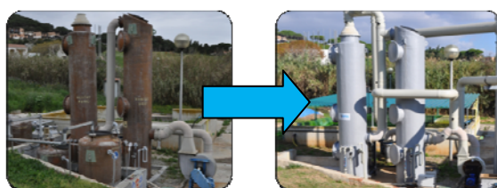
Conversión de dos lavadores químicos
